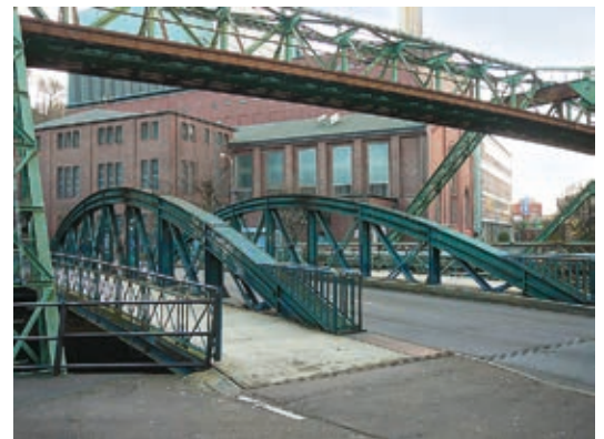
02 Renovierungsbedürftig: die 1899 errichtete Brücke „Kabelstraße“ in Wuppertal.
